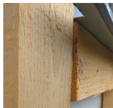
Обрешетка не в плоскости. Перекрывает вентиляционный канал.
