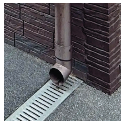
Нет зазора между панелью и отстойкой.
