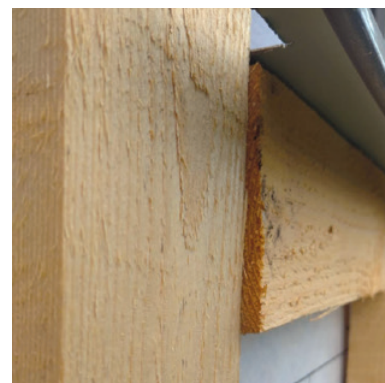
Обрешетка не в плоскости. Перекрыт вентиляционный канал.
