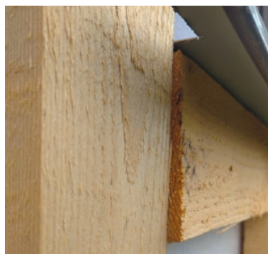
Обрешетка не в плоскости. Перекрыт вентиляционный канал
